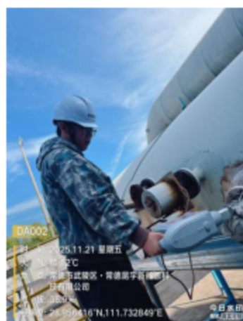
有组织废气: DA002 (CD-12-DA06) 废气焚烧炉排口
